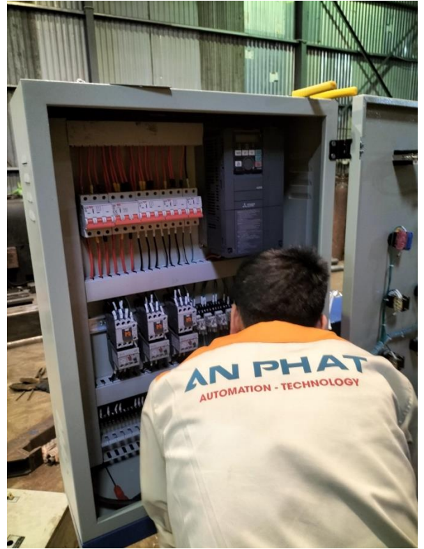
Hệ điều khiển PLC, HMI, DC driver cho máy thu cáp PLC, HMI, DC driver control system for cable winding machine
