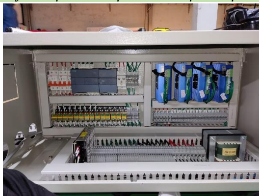
Hệ thống điều khiển máy mài - Control system for Grinding machine
